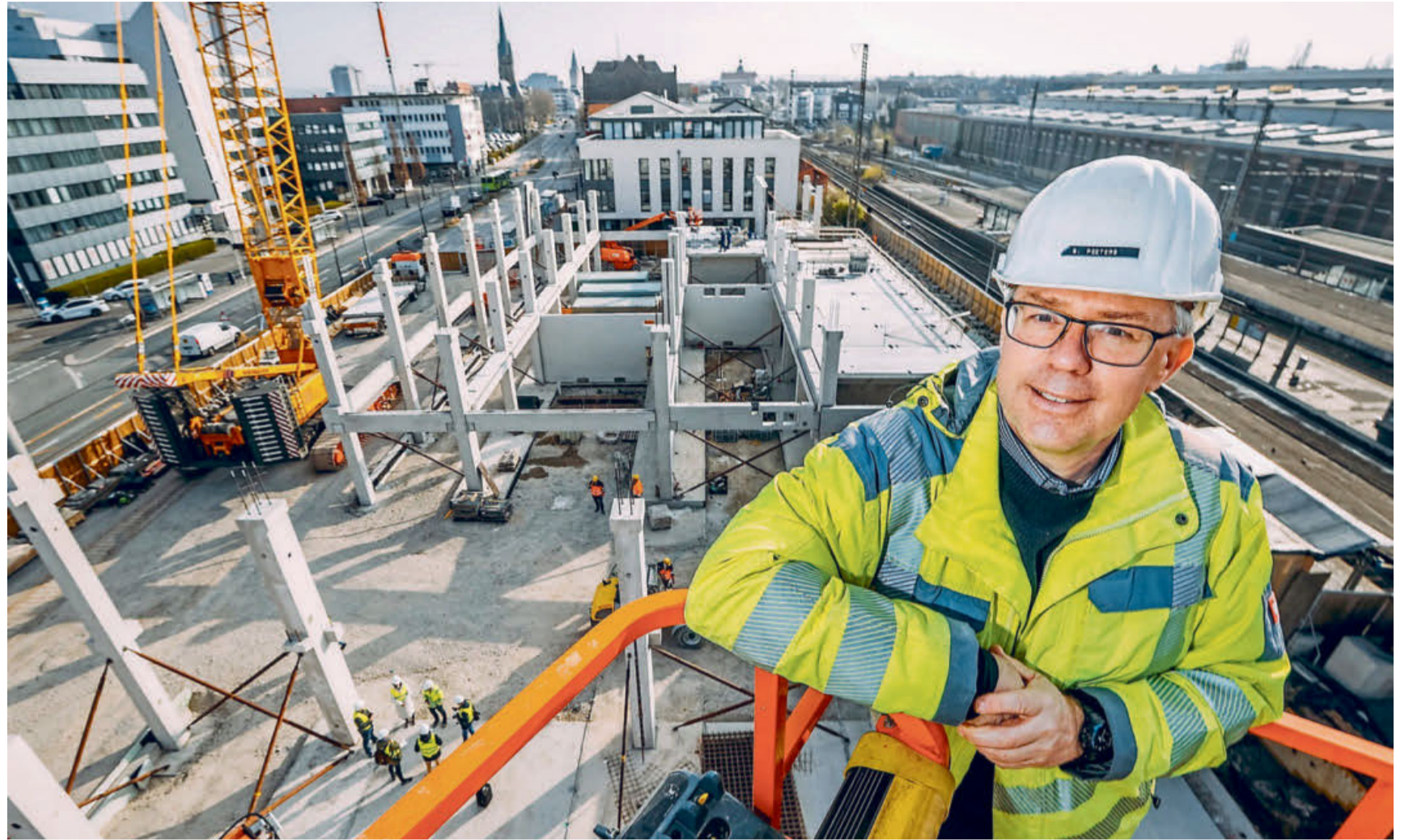
„Links unten befindet sich der künftige Haupteingang des Paderborner Hauptbahnhof“, berichtet Steven Peeters, der für den Oberbau zuständig ist. Foto: Jörn Hannemann
