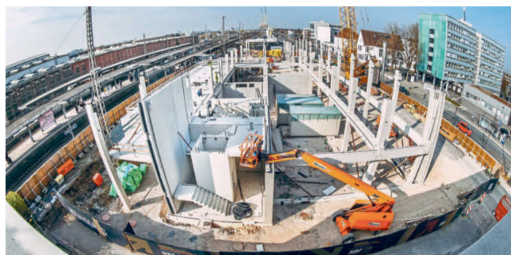
Blick von der Mobithek: Bereits sieben Tage nach dem Beginn der Hochbauarbeiten nimmt der Bau zusehends Formen an. Die Pfähle lassen bereits die Dimensionen des Neubaus erahnen.
